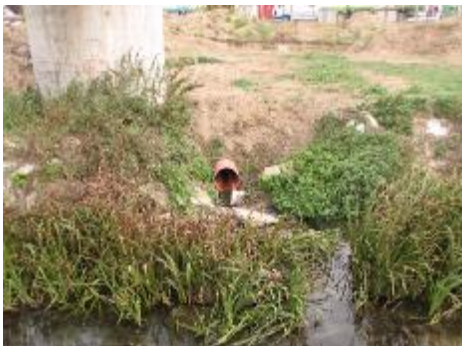
19. Az önkormányzat probléma kezelése: szennyvíz túlfolyó kiépítése közvetlen a Sződrákosi-patakba (a Mogyoródi úti hídnál)
