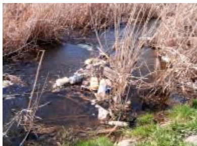
8. Szemét a Patak utcai és a Mogyoródi úti hidak közötti patakszakaszon
