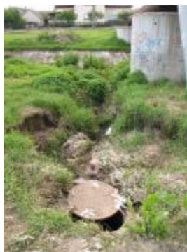
12. Májusban a Mogyoródi úti híd lábánál (az Sz16 és az Sz17 mérőpontok között) a víznyomás még a csatornafedőt is odébb lökte...
